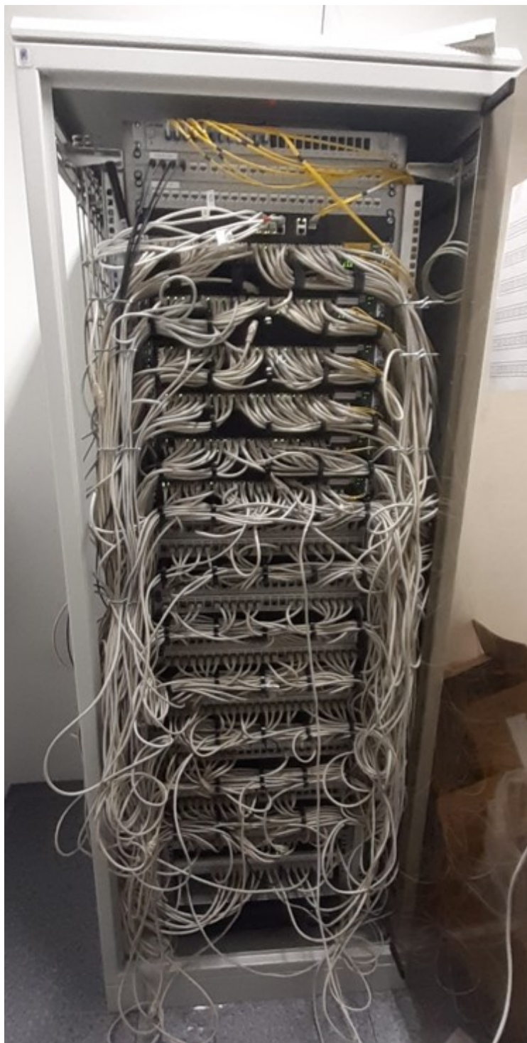
Rys. Szafa RACK 42U o oznaczeniu FD6.A – widok stanu istniejącego.
